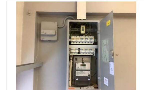
El-anlegg/sikringskap i 2. etg.
