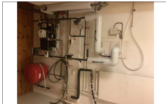
Tekniske installasjoner for vannbåren varme i kjeller.
