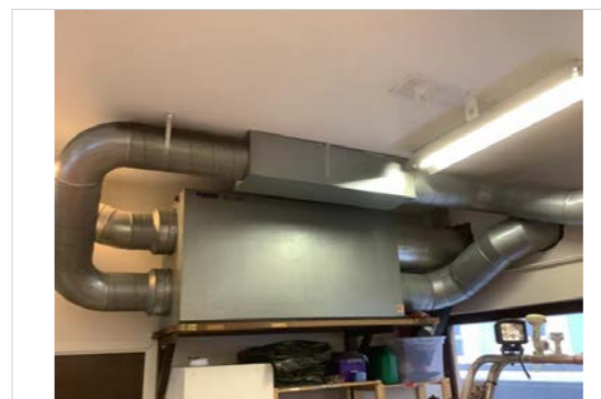
Ventilasjon i verksted i 1. etg.
