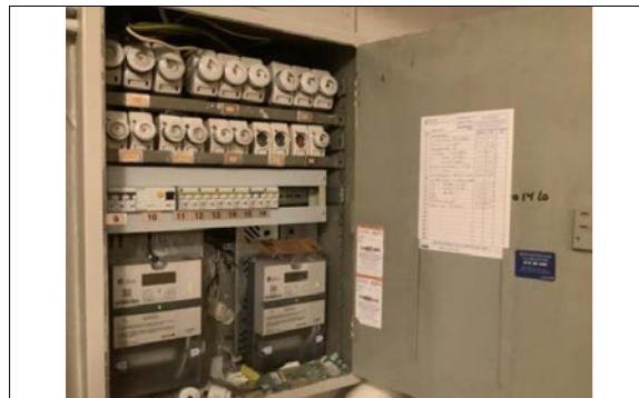
Sikringskap i kjeller.
